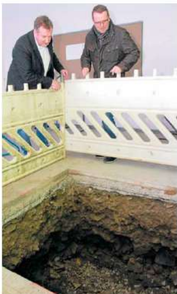
Ein Loch tut sich derzeit in einem der Schulräume auf und dient der Erkundung als eine der Vorstufen für die Baumaßnahme Fahrstuhl-Installation. Die steht Schulleiter Oliver Bollmann und Landkreis-Mitarbeiter Ingo Strümpfler noch ins Haus.
